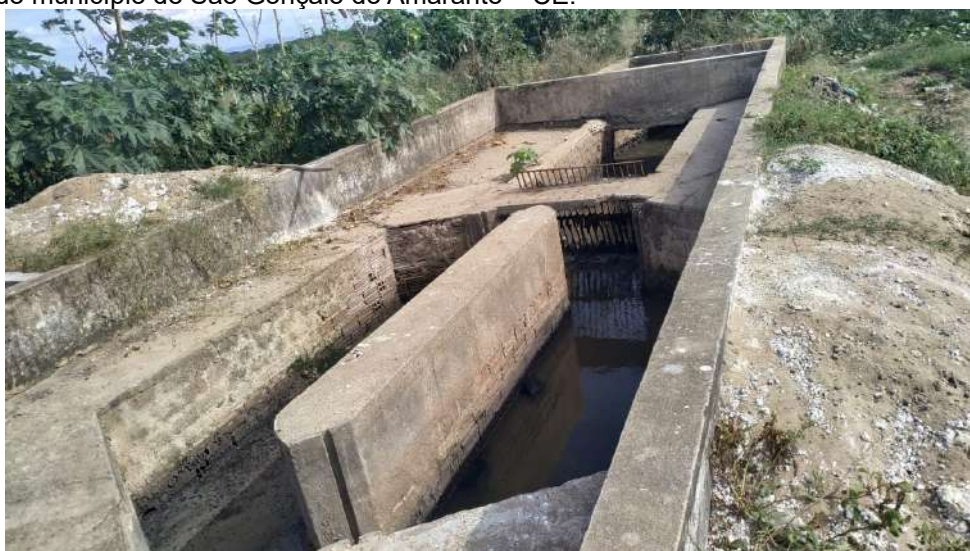
Figura 71: Unidade de tratamento preliminar (gradeamento, caixa de areia e Calha Parshall) do SES da Sede do município de São Gonçalo do Amarante – CE.
