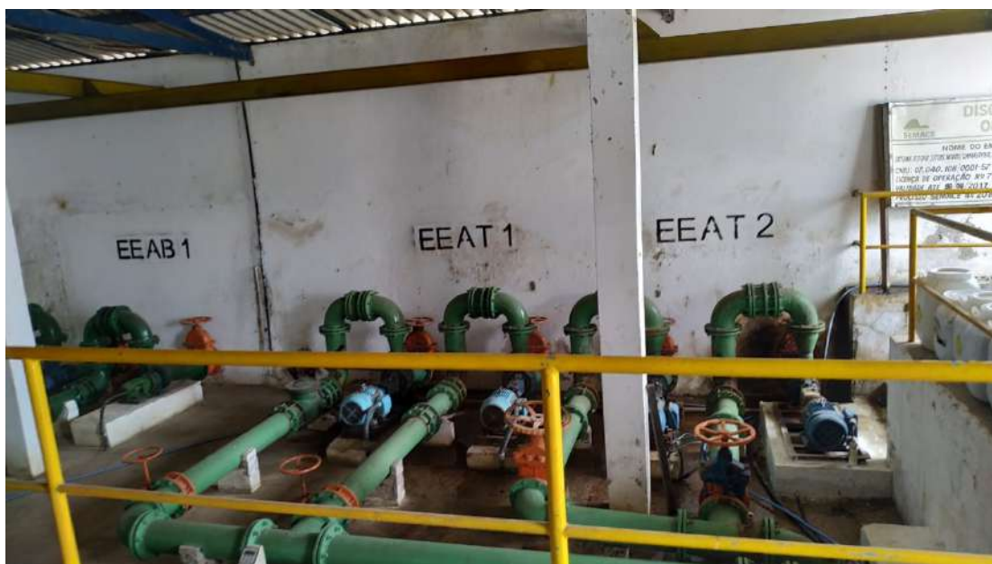
Figura 24: Conjuntos motor-bomba da EEAB do Canal do Sítios Novos e das EEAT-01 e EEAT-02.
