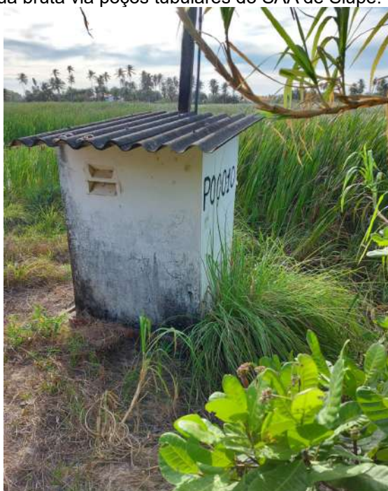
Figura 47: Captação de água bruta via poços tubulares do SAA de Siupé.
