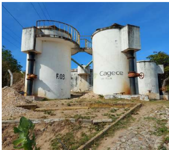
Figura 39: Unidade de filtração de fluxo ascendente.
