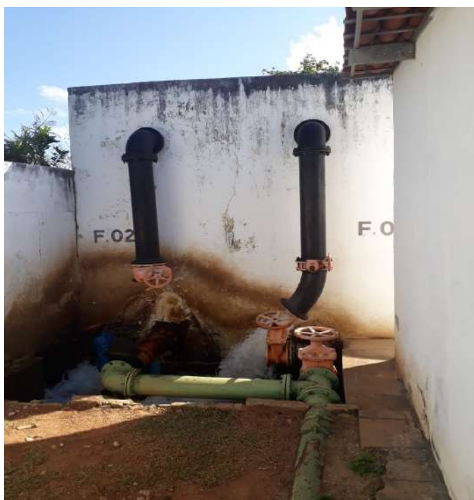
Figura 60: Unidade de filtração de fluxo ascendente.
