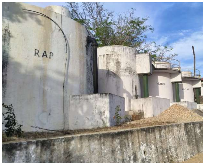
Figura 52: Reservatório apoiado RAP-01 do SAA Siupé.
