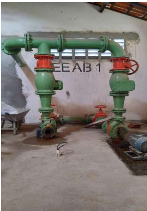
Figura 51: CMB da EEAB-01 do Sistema de Abastecimento de Água de Siupé.
