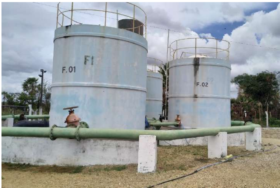
Figura 22: Unidade de filtração de fluxo ascendente.
