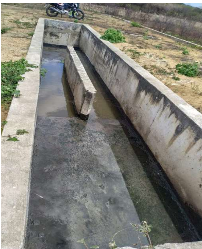
Figura 83: Unidade de tratamento preliminar (caixa de areia com Calha Parshall) da ETE Croatá do município de São Gonçalo do Amarante – CE
