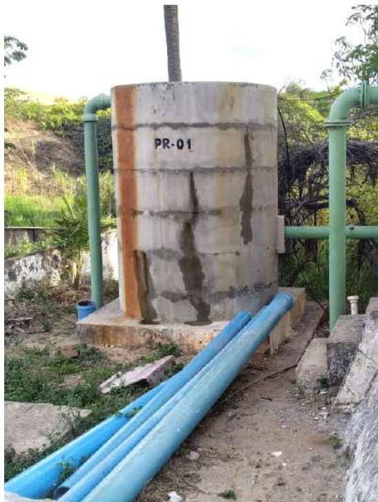
Figura 49: Poço de reunião PR-01 da ETA Siupé no município de São Gonçalo do Amarante – CE.
