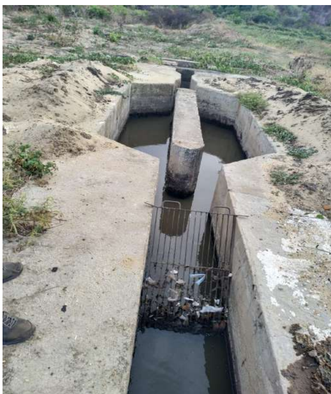
Figura 77: Unidade de tratamento preliminar (gradeamento, caixa de areia e Calha Parshall) do SES Pecém do município de São Gonçalo do Amarante – CE
